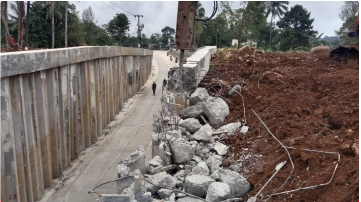
Diduga Proyek Gagal Kontruksi
